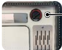
Regler der Heizungsanlage
